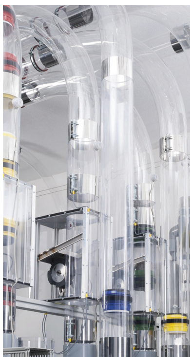
Sistema di posta pneumatica
